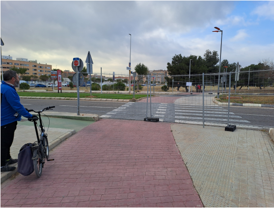
Corte de carril bici CR-400 debido a obra civil. Nula señalización en sentido Païporta–Catarroja (imagen tomada durante la inspección)
