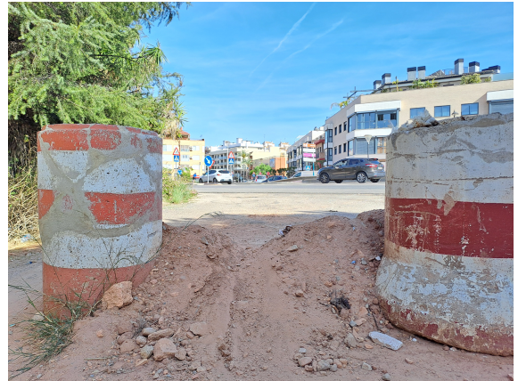
Detalle que muestra la colocación intencional de tierra y de cómo ha sido sorteada por el uso (imagen tomada durante la inspección)
