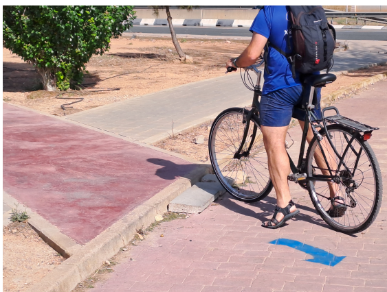
Deficiencia constructiva en la conexión del carril bici Catarroja - Albal (imagen tomada durante la inspección)
